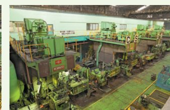
棒鋼仕上圧延機
