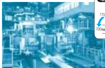
電気炉連続铸造機
